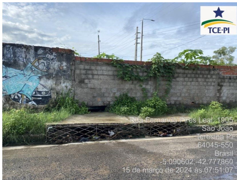
Figura 19: Bocas de Lobo com gradeamento improvisado.
